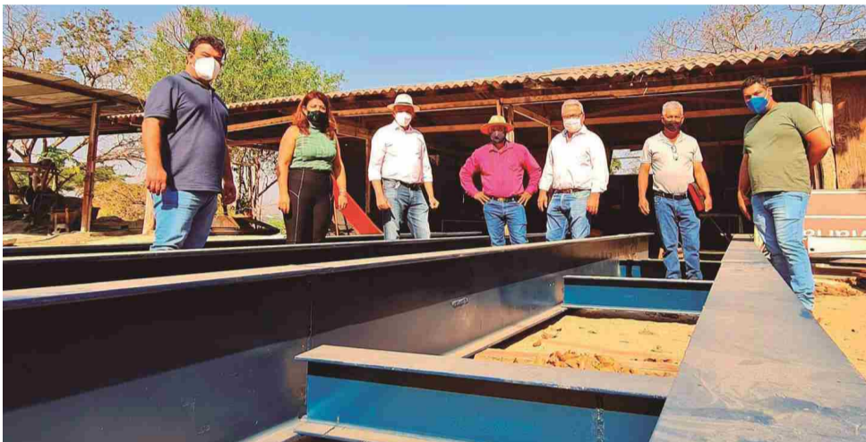
O produtor rural Uplínio Faria transportou a estrutura da ponte, que já está no local
